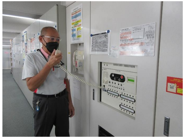
■非常用放送設備による放送訓練
